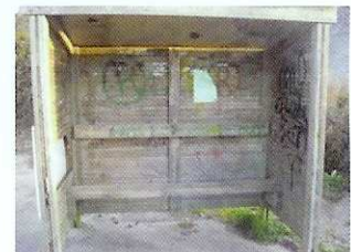
L'abri bus délabré de la salle des fêtes n'invite vraiment pas à utiliser les transports publics de voyageurs
